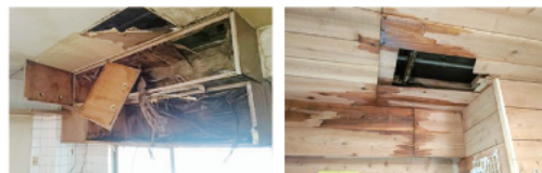
老朽化した部屋(左)を自分たちで修理して使っていますが、たびたび水漏れ等(右)が発生しています。
